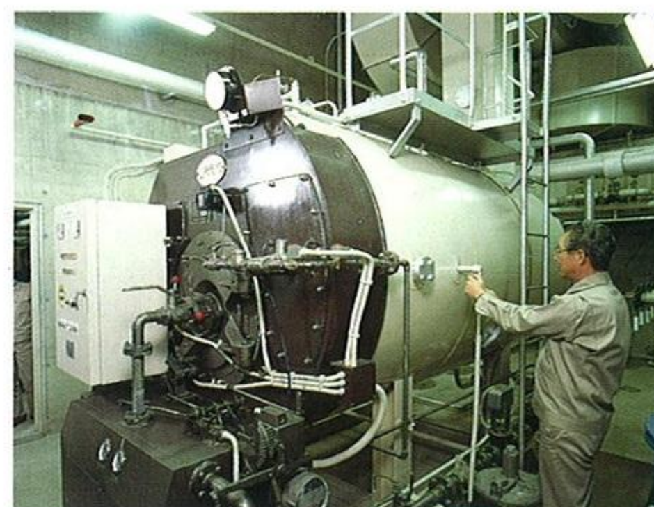
● 冷暖房・空調関係器の点検・整備 ● 冷凍機の運転・管理 ボイラー、冷凍機、空調機等は一級ボイラー技師により 厳重に点検・整備し、空気環境等を保全します。
