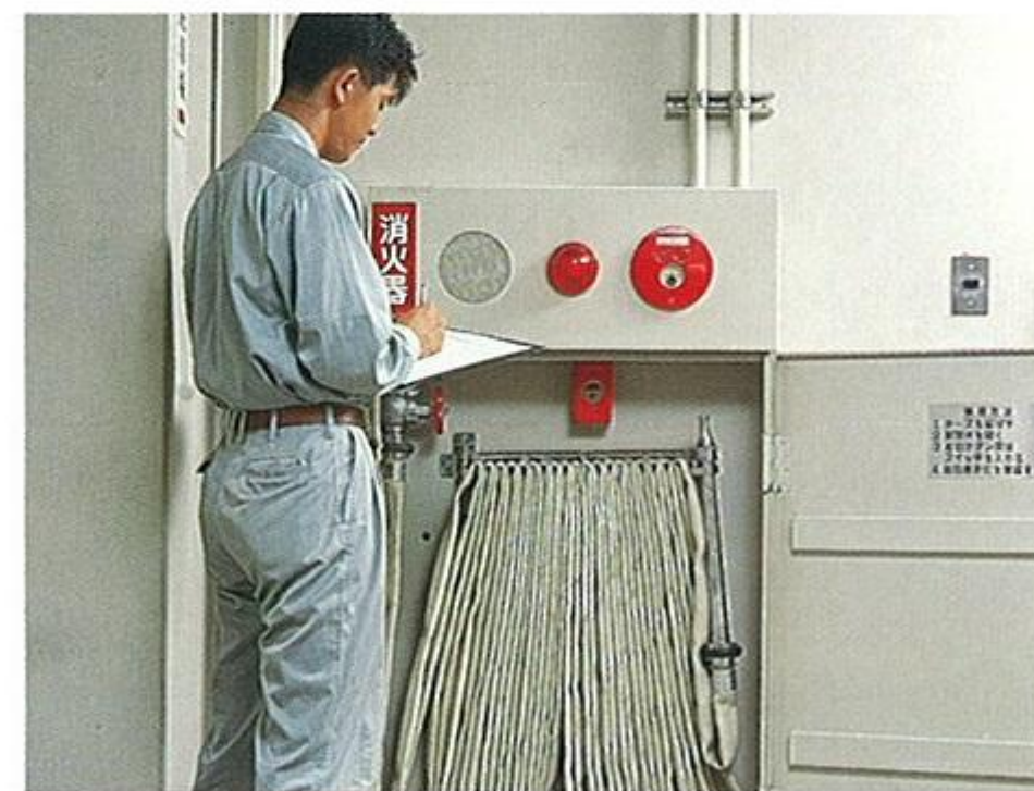
● 消防用設備等点検 消防用設備等の点検をすることにより機器の機能を十分に発揮できるよう維持管理します。
