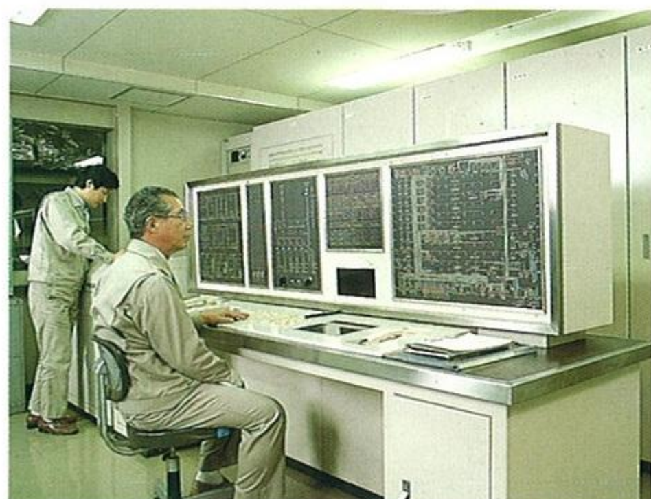
● 中央監視盤による集中管理システム 館内全般の機器の作動状態を常時、把握し 異常時には直ちに対応します。
