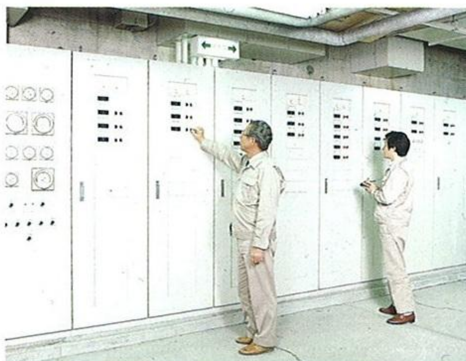
● 電気設備の点検と保守 受電設備、照明設備、動力設備等を各点検項目に従い ながら、丹念にチェックし常に万全を期しています。
